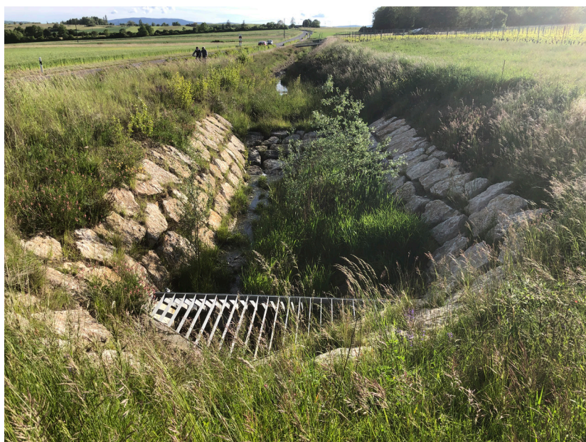
Bassin récoltant les eaux du coteau viticole, Sézenove, Bernex
