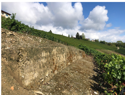
Mur de soutènement à restaurer
